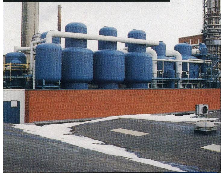
Indunstare. Flerstegsindunstningsanläggning för koncentrerings av sulfatlut.
