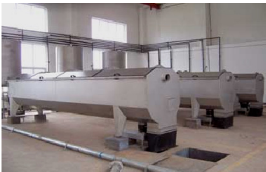
3 st Slasken SF 60 trumförtjockare installerade i reningsverket i ZhuZhou, Hunan, Kina
