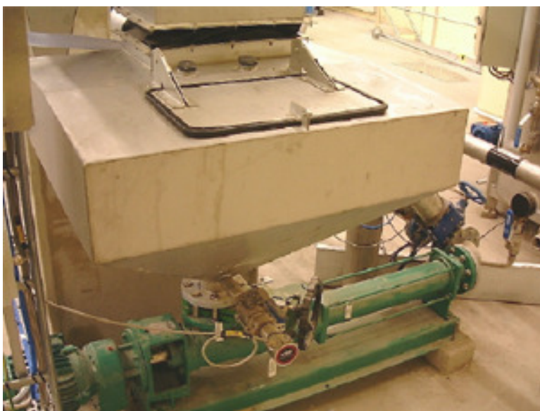
Slamtratt från slam- förtjockare, med an- slutning till excenter- skruvpump för trans- port av förtjockat slam till rötkammare
