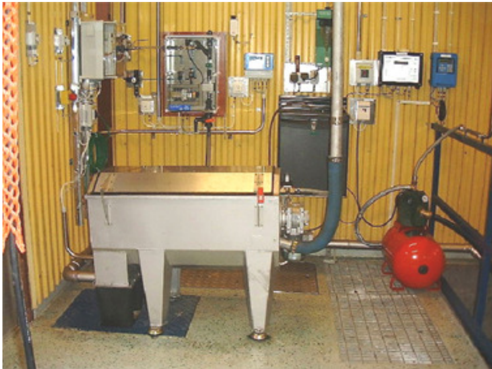
En Slasken SF 3 (den minsta maskinen, 3 kbm/tim) installerad i ett litet reningsverk i mellansverige; Monterad på väggen en Siljan PolySave-enhet, som styr polymertillsatsen och därmed minimerar behovet av tillsyn, gör 24 timmars drift mer pålitlig och sparar en hel del dyrbar polymer. Efter förtjockningen transporteras slammet till ett centralt reningsverk för rötning.
