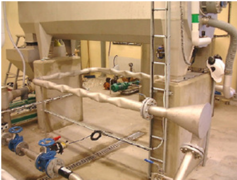
Konisk mixer samt rörmixer för flock- ning före slamför- tjockning
