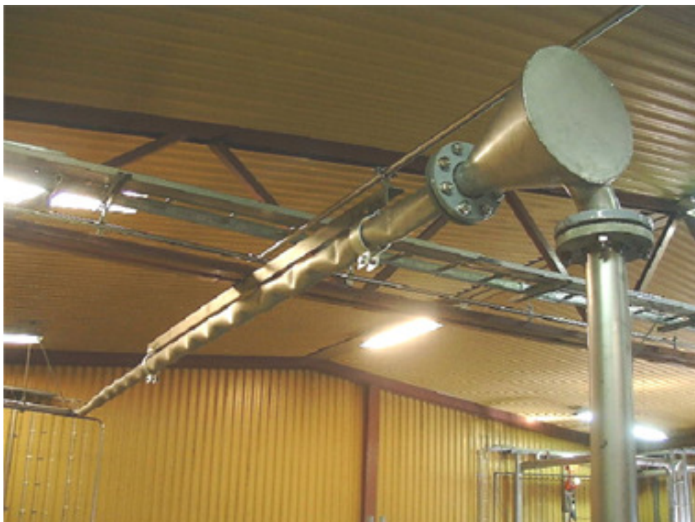
En konisk mixer samt en rörmixer har installerats i taket ovanför förtjockaren för att spara plats
