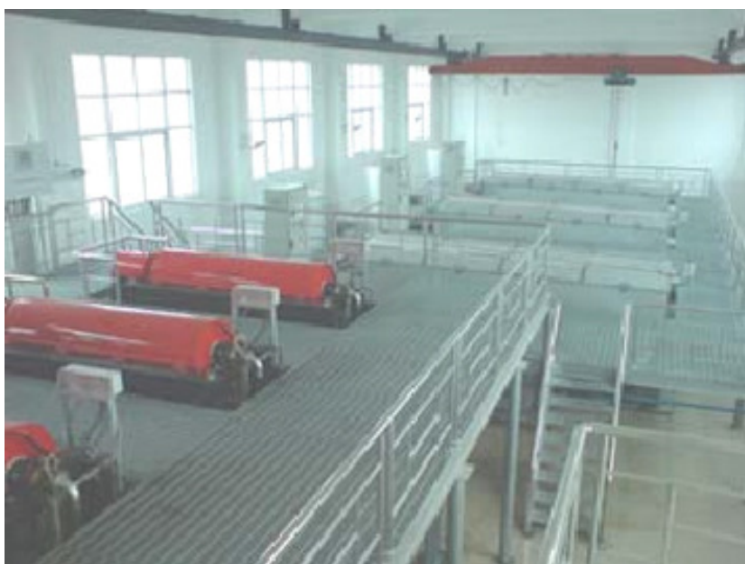
Installationen i reningsverket i Chandong, Kina
