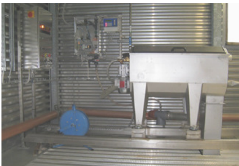
1 st. Slasken SF3 inklusive Siljan PolySave, under drift i ett mindre reningsverk i Småland.
